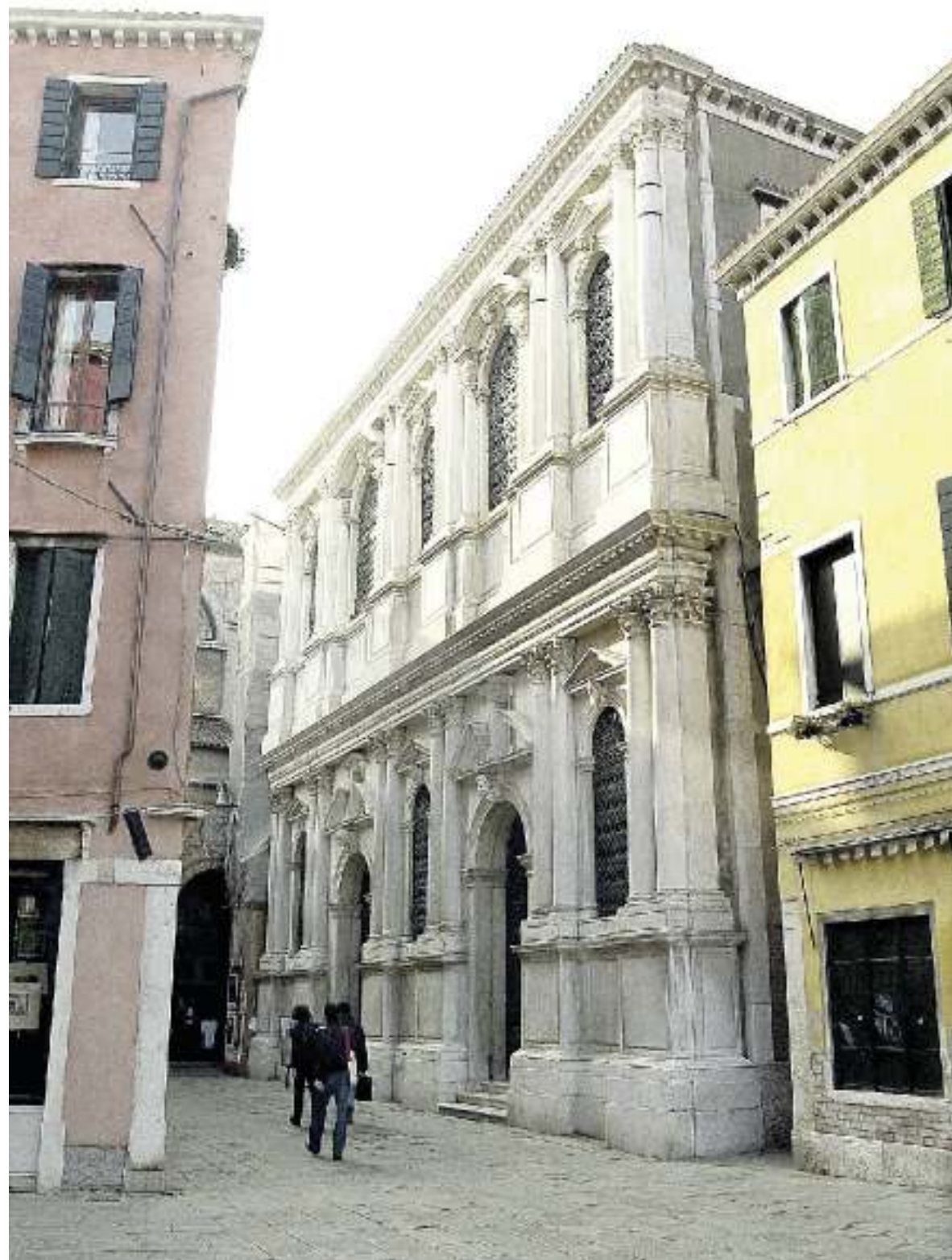
FACCIATA IN PERICOLO La Scuola Grande dei Carmini. L'appello per uno sponsor per restaurare i delicati marmi è caduto fino ad ora nel vuoto
